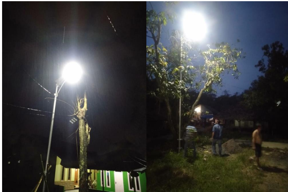
(a) (b) Gambar 4. PJU menerangi kampung Cipalahlar
