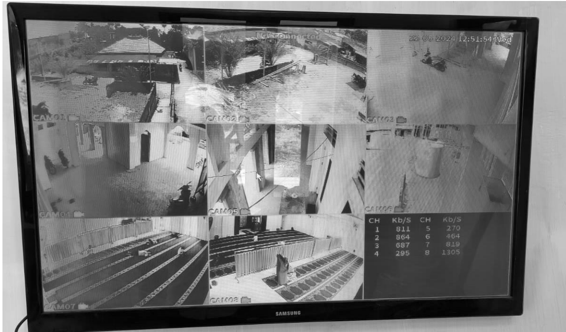
Gambar 10. Gambaran pemantauan CCTV 8 channel di ruang petugas mesjid
